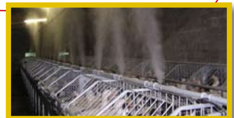
La brumisation associée à la ventilation intégrée, permet d'optimiser l'ambiance dans le bâtiment à consommations d'eau et d'électricité réduites. Elle facilite aussi le nettoyage et permet de traiter ou désinfecter lors du vide sanitaire
