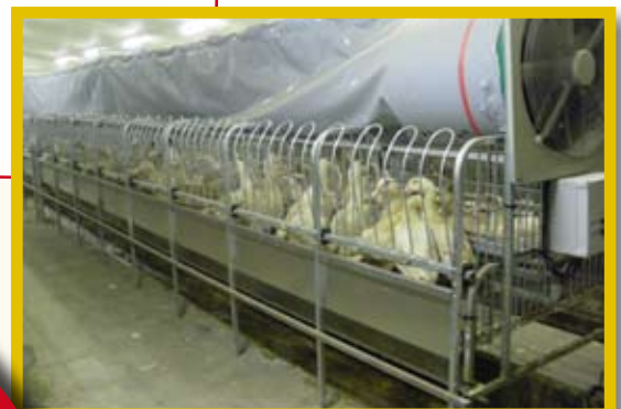
Ventilation par gaine optimisée par un décroché qui permet d'abaisser la gaine et la présence d'une grille à petite maille qui empêche aux canards de toucher à la gaine
